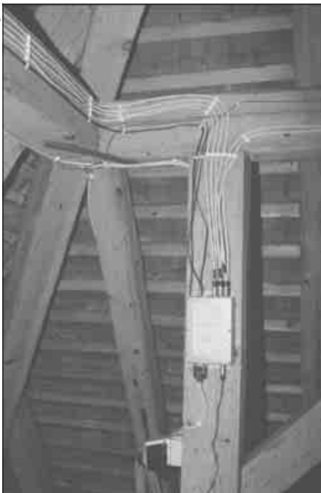
Die „Black box“, das Herzstück der Anlage auf dem Dachboden der Hebelschule. Hier laufen die Signale der einzelnen Lichtschranken und Sensoren zusammen und werden, nach Auswertung durch einen Mikroprozessor, an den PC im darunterliegenden Zimmer übermittelt.
